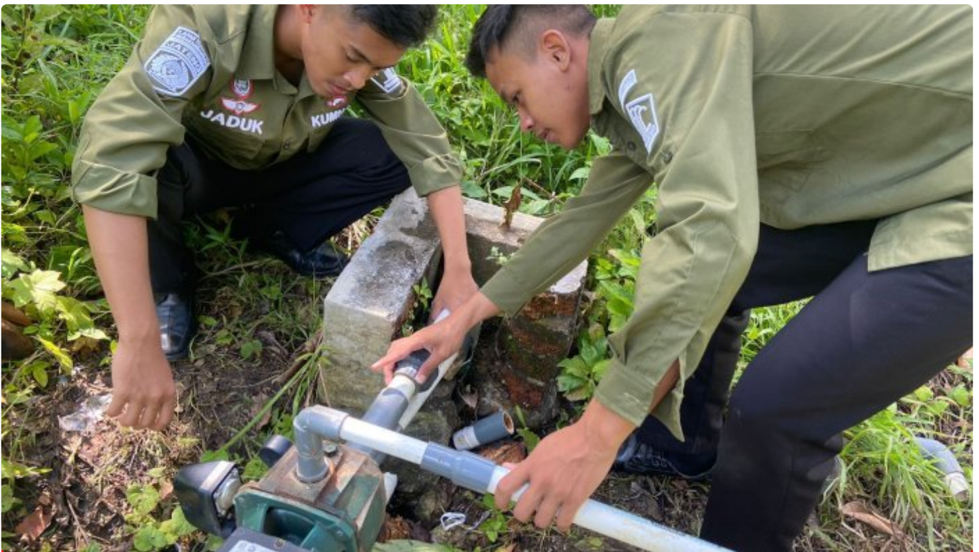
Petugas Lakukan Pengecekan Panel Meter Listrik dan Air
